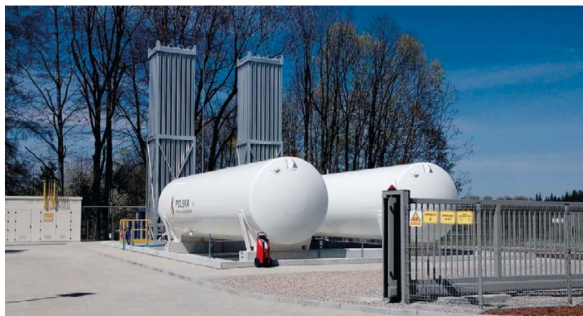
Fot. 3. Stacja regazyfikacji LNG w m. Białka Tatrzańska. Fot. arch. PSG sp. z o.o. Oddział Zakład Gazowniczy w Krakowie
