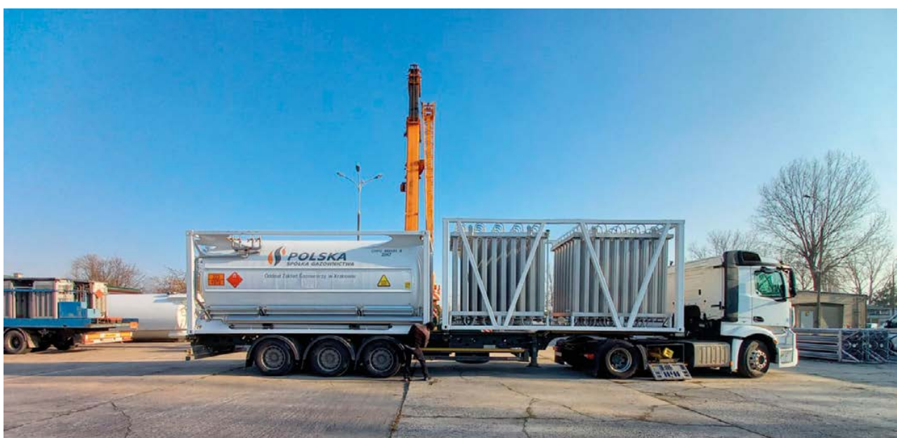
Fot. 7. Infrastruktura LNG na potrzeby zasilania awaryjnego (zestaw parownic i zbiornika cysterny w ramach kontenerów ISO 20 ft.). Fot. arch. PSG sp. z o.o. Oddział Zakład Gazowniczy w Krakowie
