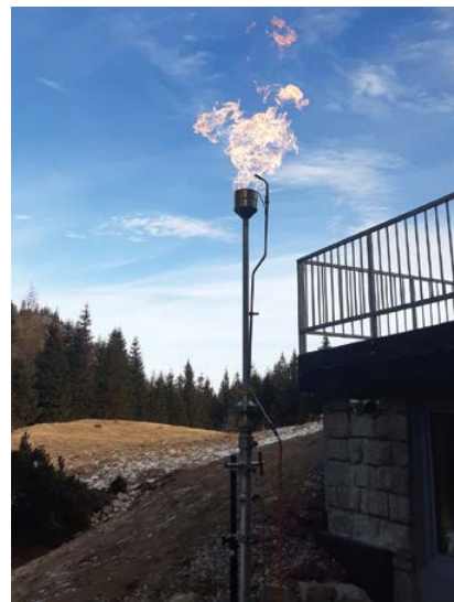
Fot. 1. Gaz spalany na kolumnie w czasie zagazowywania sieci zasilającej m.in. Hotel Górski PTTK Kalatówki. Fot. arch. PSG sp. z o.o. Oddział Zakład Gazowniczy w Krakowie
