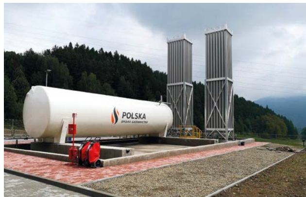
Fot. 5. Stacja regazyfikacji LNG w m. Rytró. Fot. arch. PSG sp. z o.o. Oddział Zakład Gazowniczy w Krakowie
