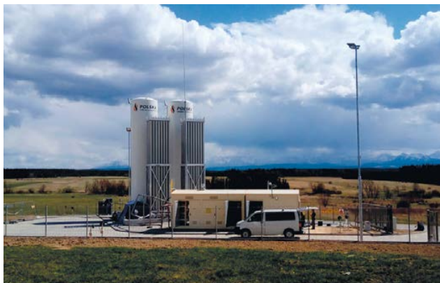
Fot. 4. Stacja regazyfikacji LNG w m. Jabłonna. Fot. arch. PSG sp. z o.o. Oddział Zakład Gazowniczy w Krakowie
