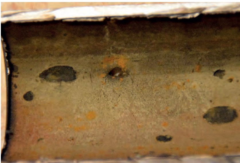
Fot. 1. Fragment rurociągu z widoczną korozją wżerową. Arch. INiG - PIB
