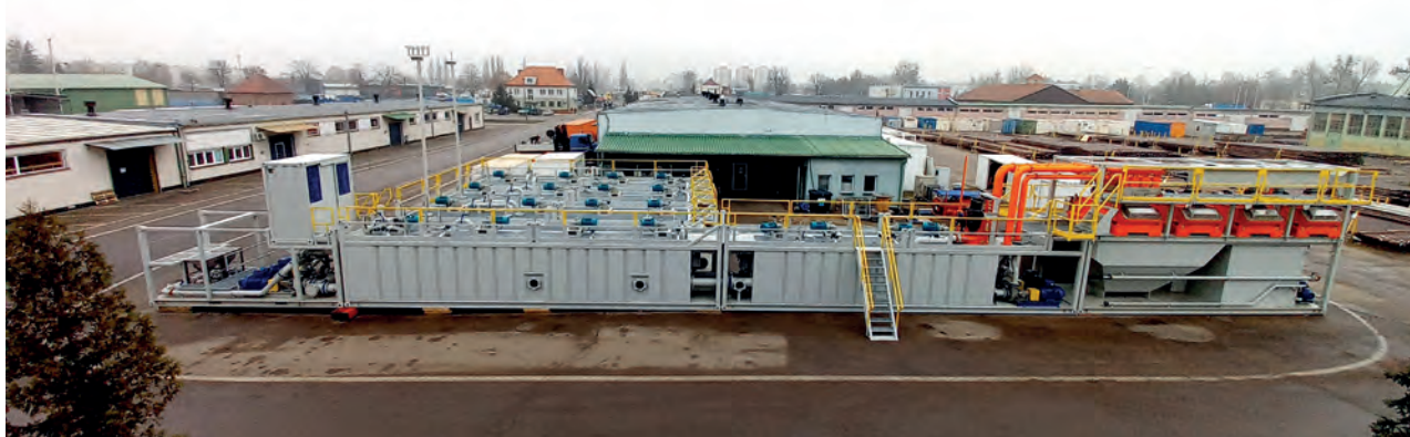
Kompletny system płuczkowy (źródło: Exalo Drilling S.A. Warsztaty Mechaniczne w Pile)
