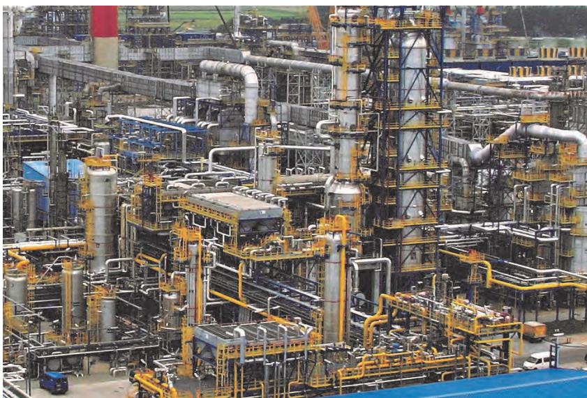
Instalacja HDS. Fot. arch. Grupa LOTOS S.A.
