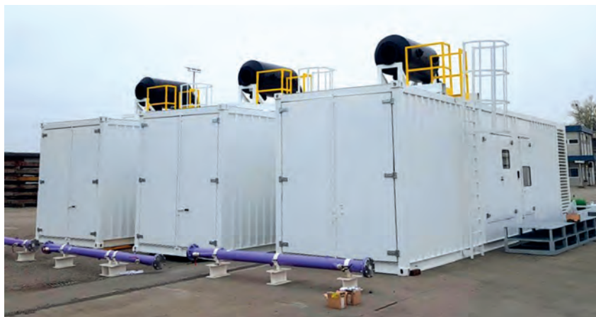
Zespół generatorów (źródło: Drillmec SPA)
